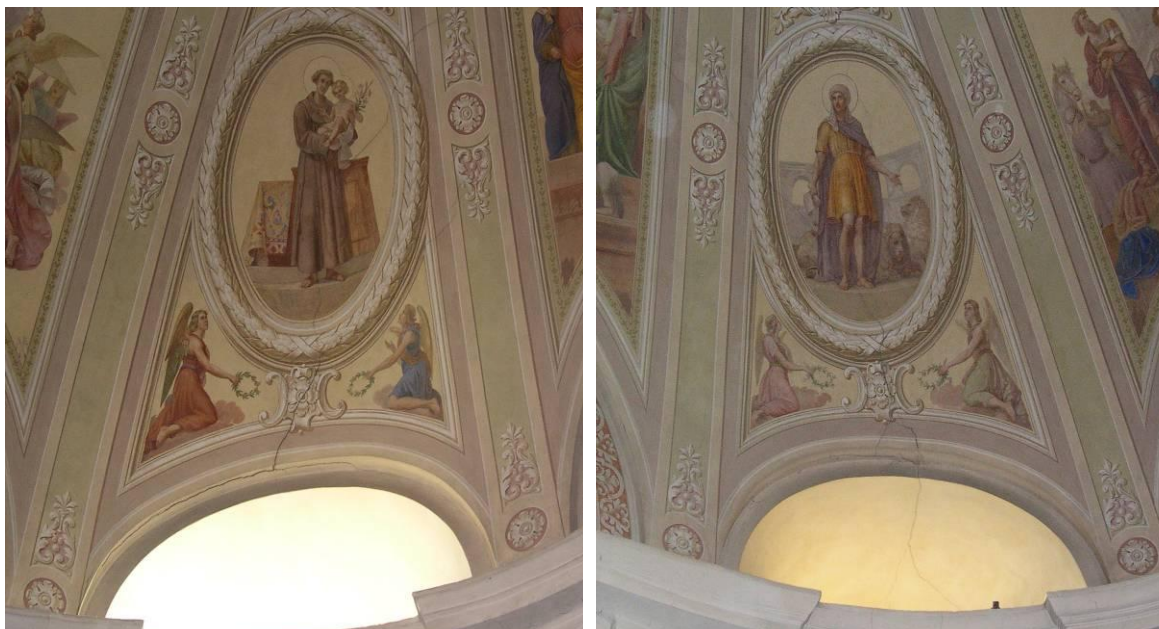
Slika 2: Široke razpoke v delu kupole nad masivnimi podpornimi slopi
