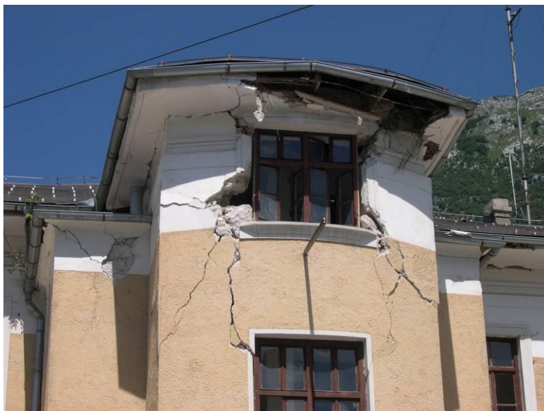
Bovec – ob potresu poleti 2004 so dobesedno razpadli zidovi nesanimiranega objekta Policije
