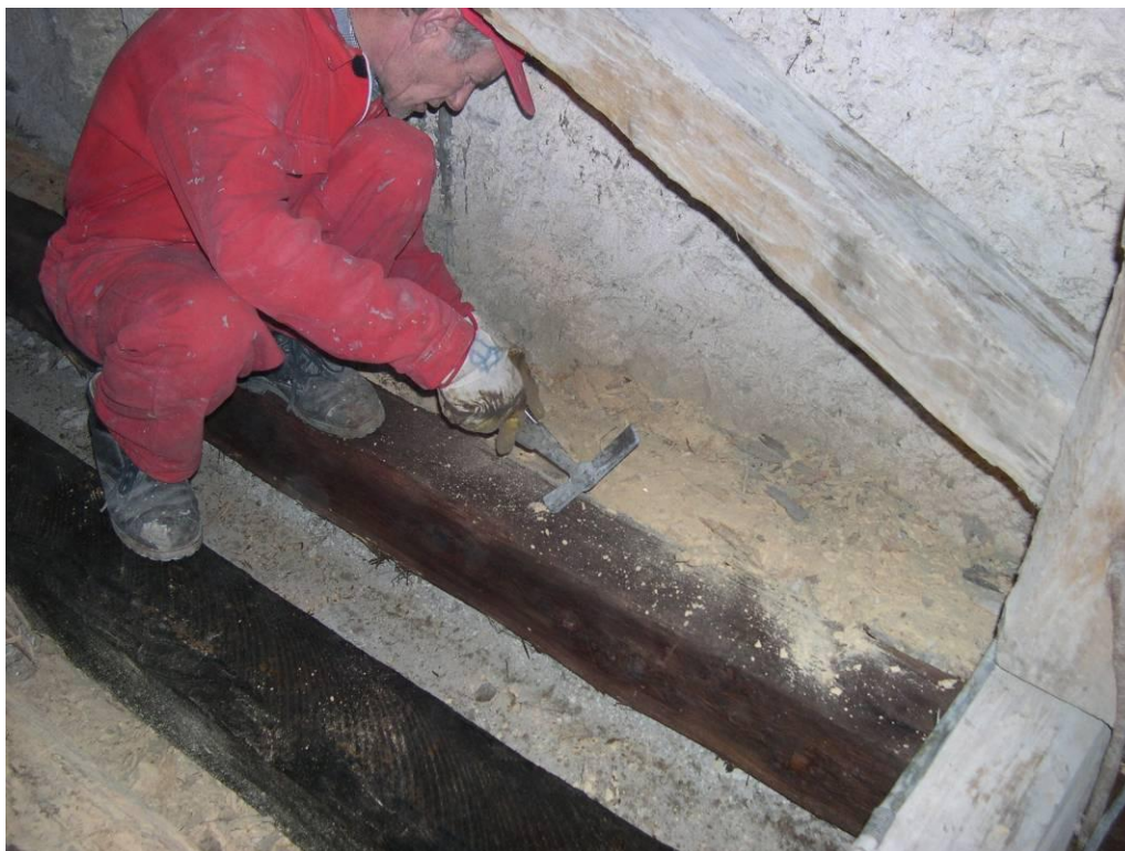
Slika 12: Poškodbe lesenega stropnika, ki je bil po celi dolžini v stiku z injektiranim zidom in brez ustreznega zračenja
