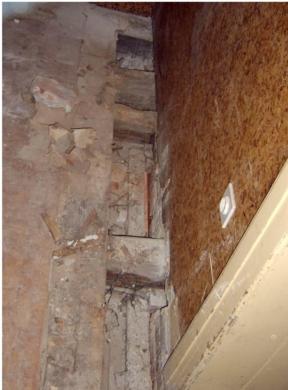
Slika 14: Po odstranitvi zaključnih paroneprepustnih slojev tudi sicer popolnoma nestrokovno izvedenega sovprežnega estriha brez ustreznega sidranja so vidni prhli stropniki
