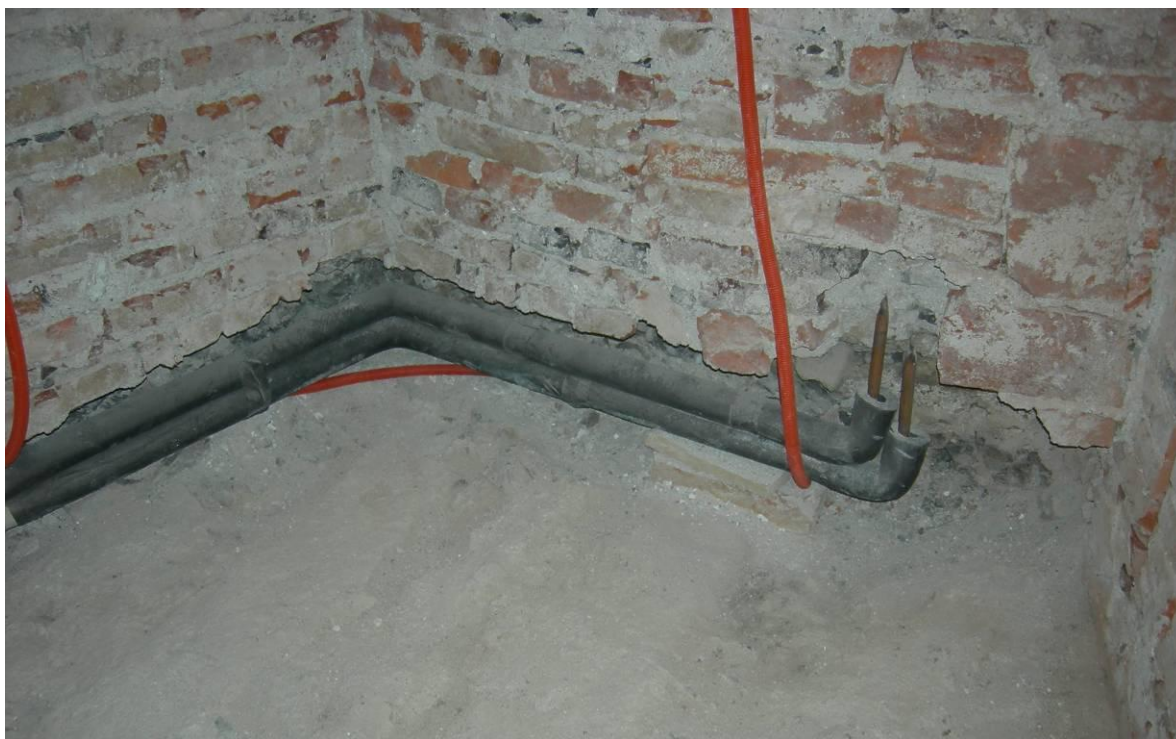
Slika 15: Primer nedopustnega posega: horizontalni inštalacijski utor globine 30 cm pomeni izrazito oslabitev zidu, ki lahko privede do porušitve (ekscentričnost) že pri nižjih obremenitvah, da o potresni varnosti niti ne govorimo
