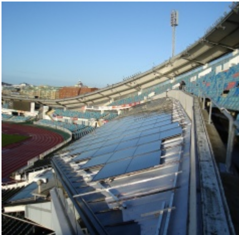
Figure C.3 Solarni fotovoltaični sistem športne arene Ullevi v Gothenburgu na Švedskem, ki napaja celoten sistem razsvetljave arene (Vir: Switchpower and GotEvent)
