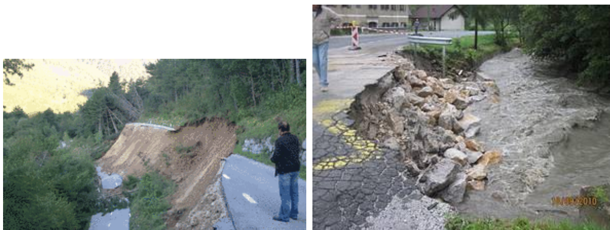
Slika 3: Porušitev vozišča (vir DRSC)
