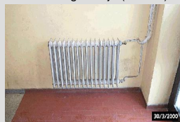
ogrevalo ob vhodu v objekt (CFB2A)
