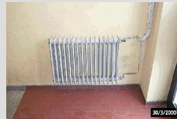
ogrevalo ob vhodu v objekt (CFB2A)
